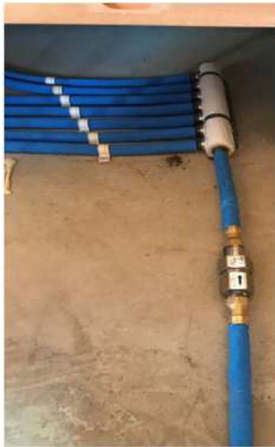
屋内設置例【給水ヘッダー】
